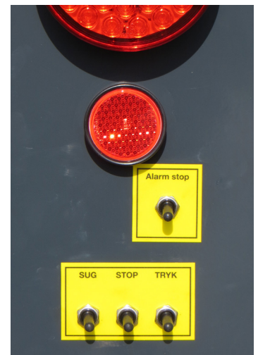
Start og stop af pumpe til påfyldning af emulsion
